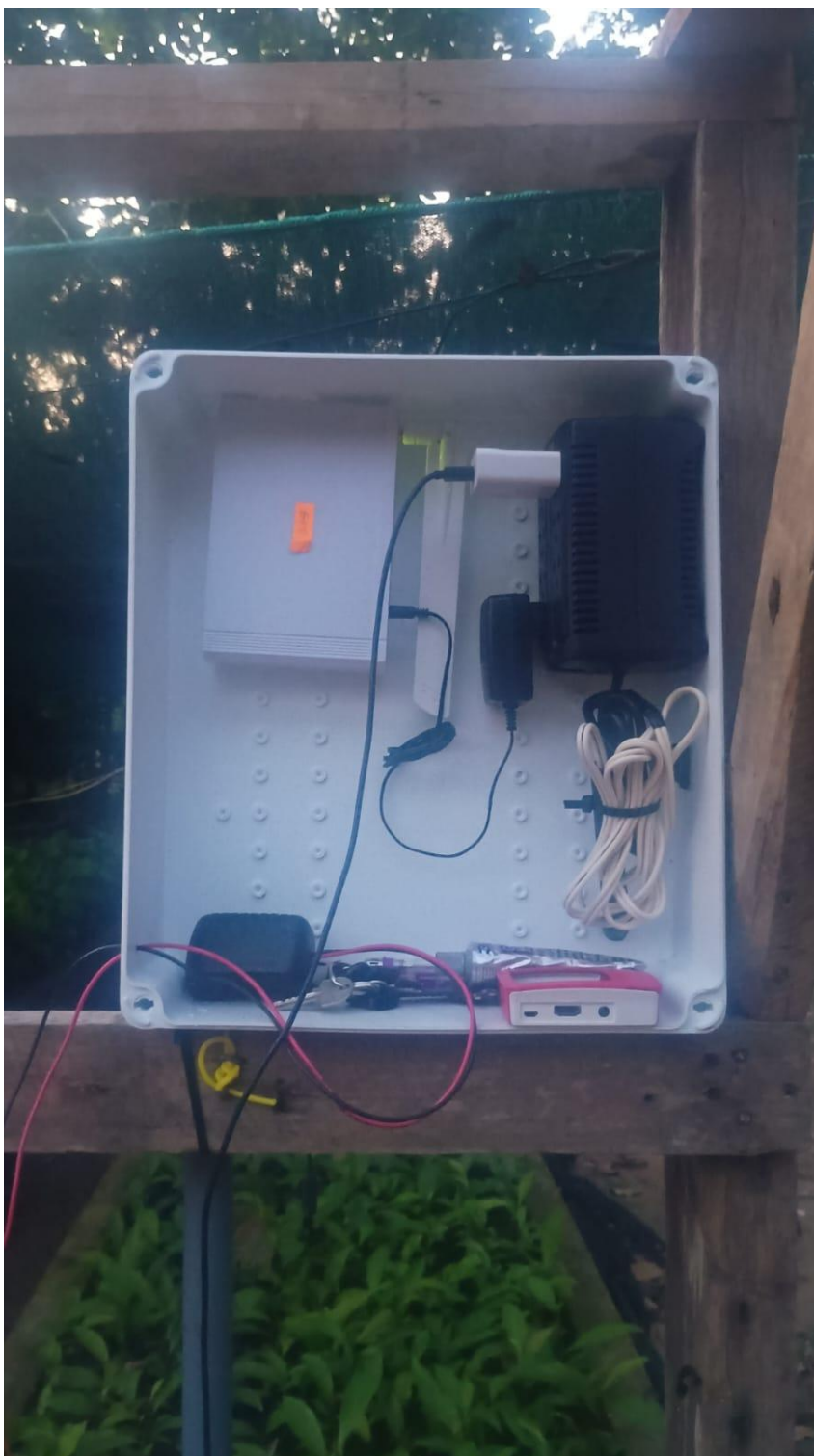
Figura 56. Instalación de Gateway, Raspberry Pi 3 y un estabilizador para regular la energía.
