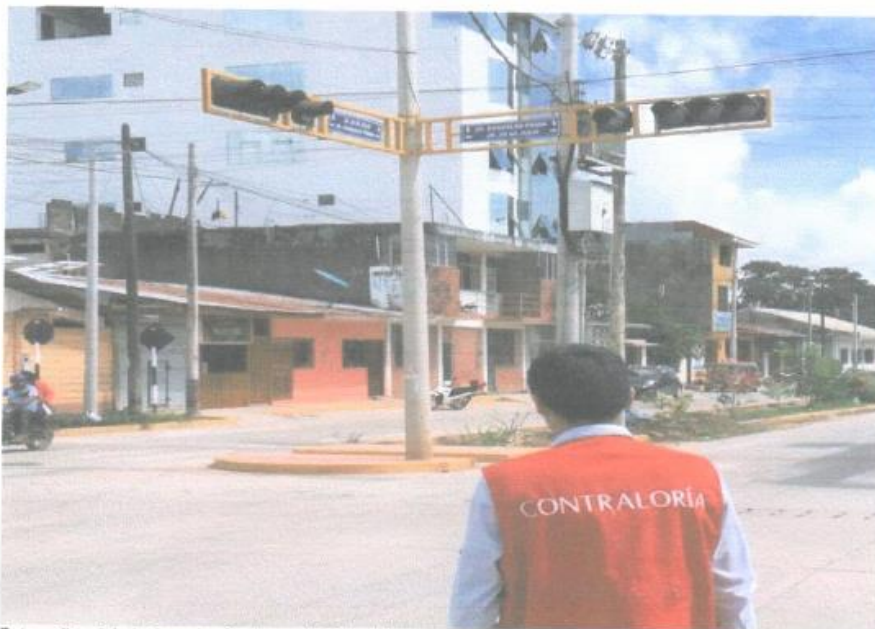
Fotografía n.º 1: Jr. Gonzales Prada con Jr. 28 de Julio semáforo inoperativo. Elaborado por: Equipo de Orientación de Oficio.
