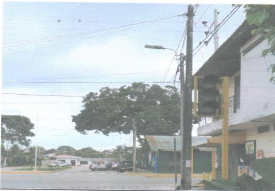
Fotografía n.º 14: Jr. Cusco con el Jr. Daniel Alcides Carrión semáforo malogrado (Luz verde deficiente). Elaborado por: Equipo de Orientación de Oficio.
