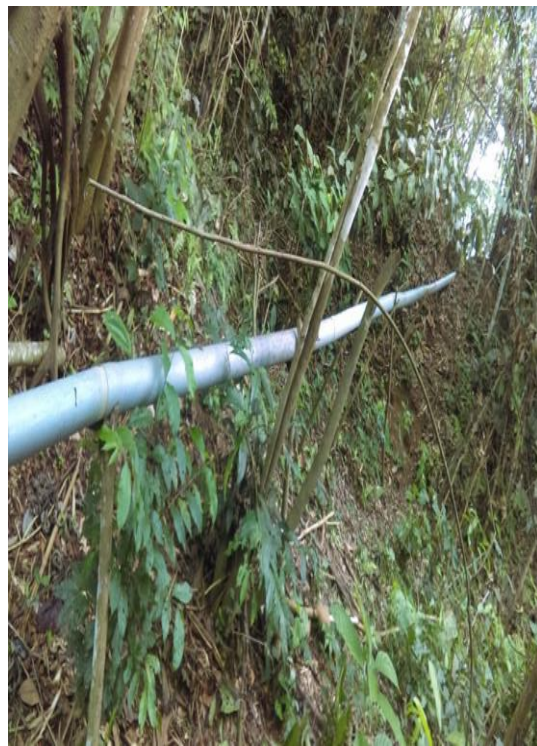
Figura 45. Tubería de captación informal para agricultura.
