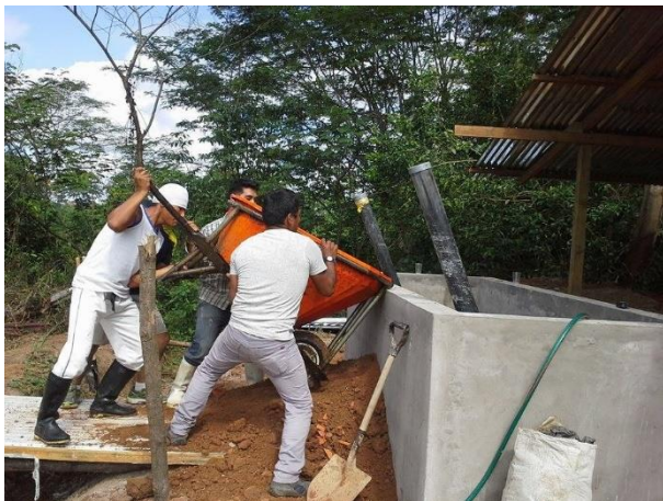
Foto 07: Vaciado de estiércol.
