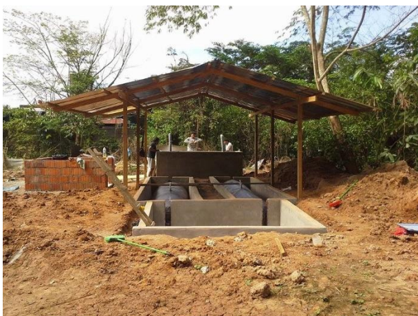
Foto 06: Sistema de biodigestión implementado.
