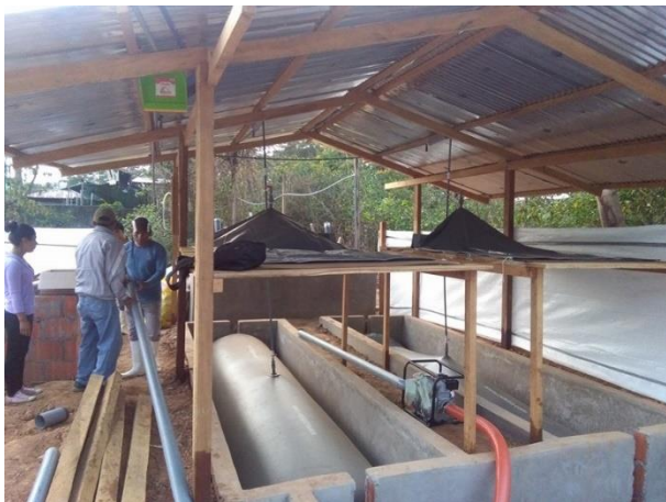
Foto 10: Reactores de geomembrana.
