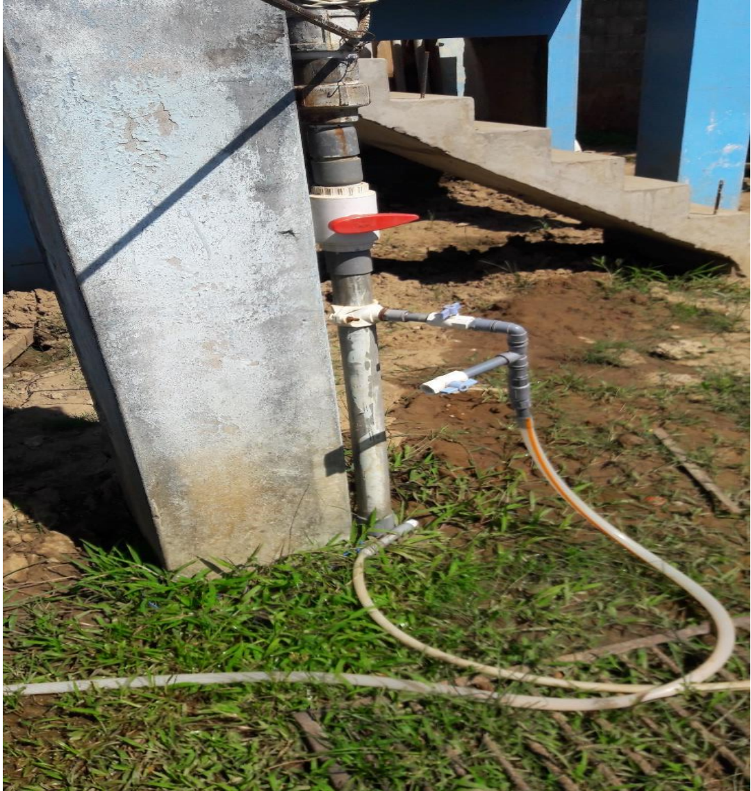
Foto 5: Pileta para toma de muestra agua
